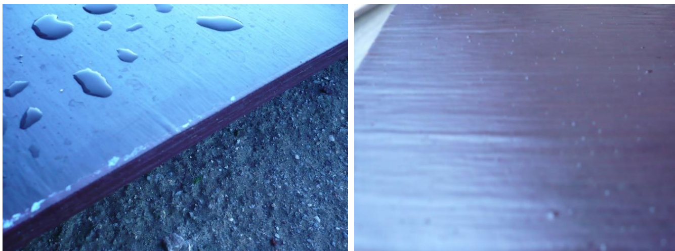
Fig. 9 y 10. Ejemplo de chapas hinchadas por cambio de humedad. Efecto Rippling.
