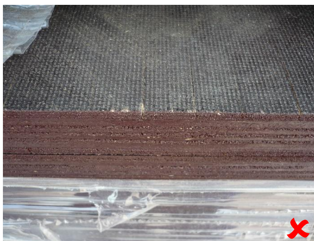
Fig. 1. Grietas de un tablero Laudio Wire, expuesto a la intemperie durante seis meses
